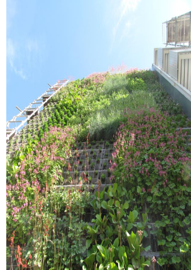
Mur vivant, Nantes (source M. Musy)
